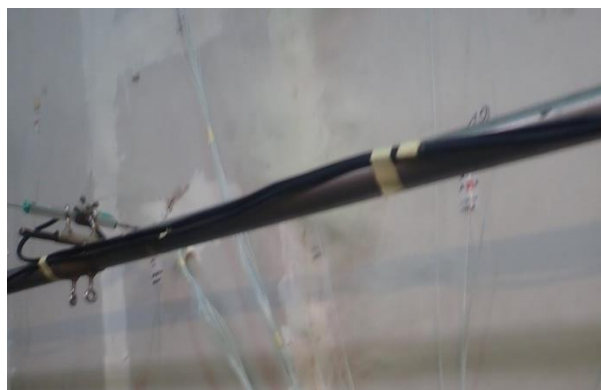
Bild 19: Prüfminute 101: Mäßiger Rauchaustritt über vertikalen Riss über der gesamten Plattenlänge am zweiten vertikalen Fugenübergang von rechts in Verbindung mit einer gelblichen Verfärbung an den Rändern des Risses. Kein Austritt von Heißgasen.
