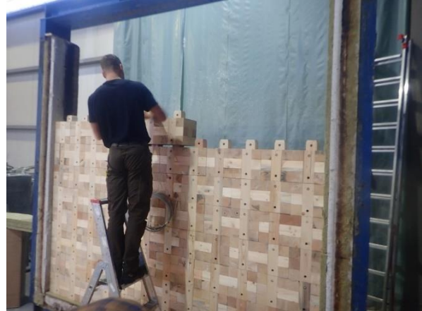
Bild 2: Blick auf die Steckmontage von dem einbringen der Buchenholzdübel zur Sicherung der Verbindungen.
