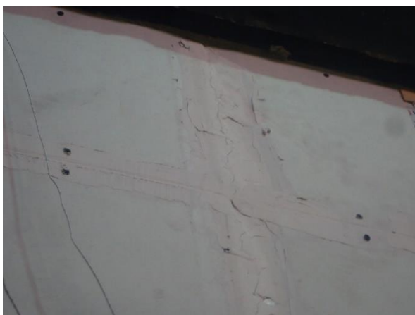
Bild 14: Prüfminute 44: Vertikaler Riss über der gesamten Plattenlänge am zweiten vertikalen Fugenübergang von rechts.
