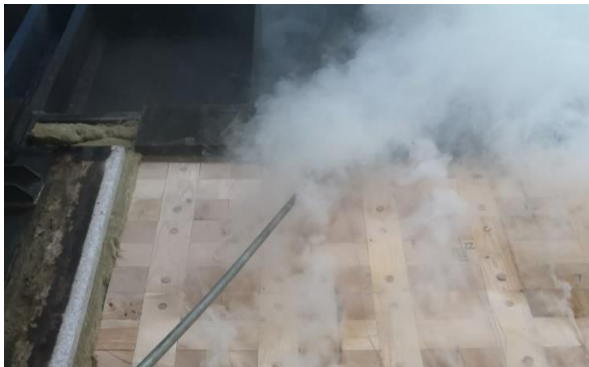
Bild 23: Prüfminute 50: 3. Wattbauschtest im Bereich der Oberflächenmessstelle OF 6, negativ.
