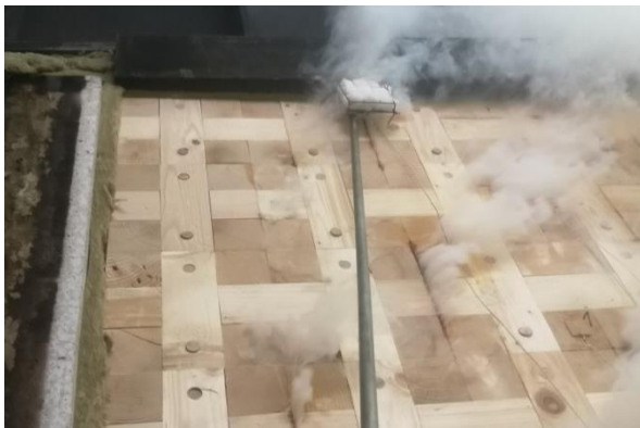
Bild 19: Prüfminute 41: 2. Wattbauschtest im Bereich der Oberflächenmessstelle OF 6, negativ.
